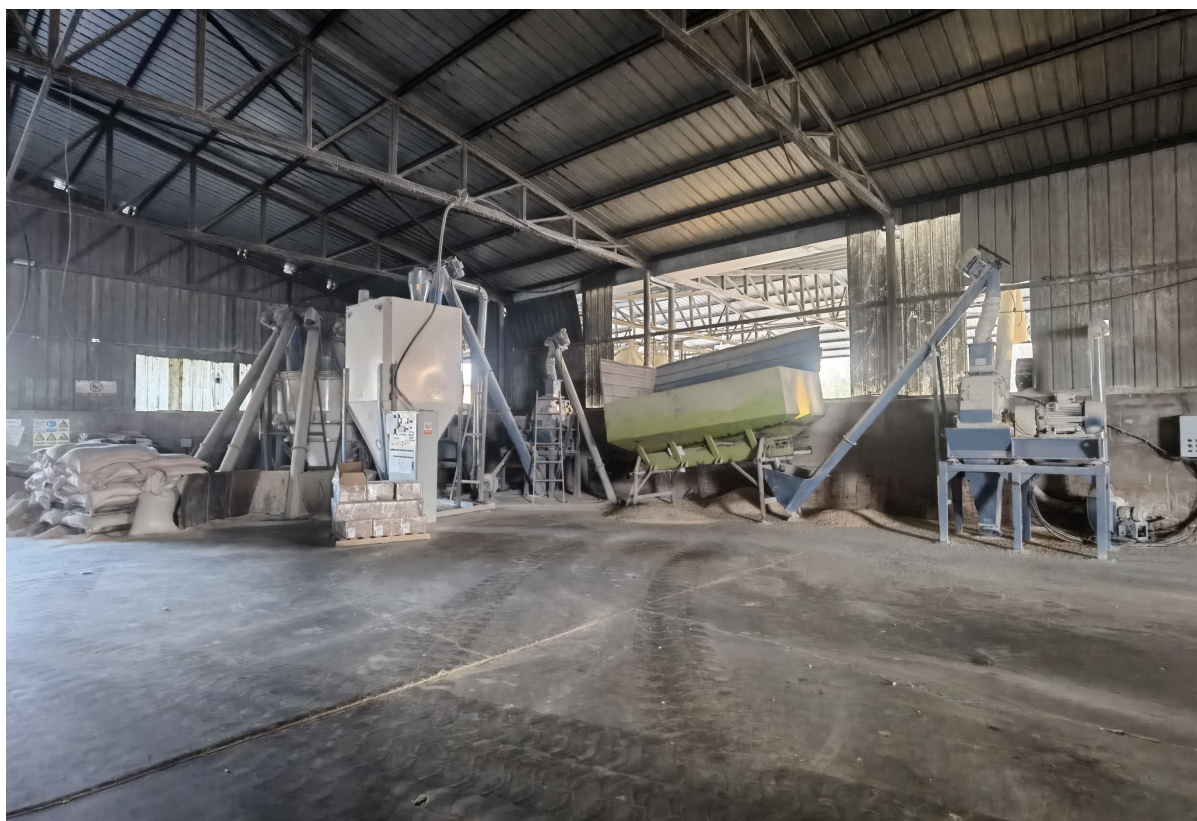
饲料破碎设施自带收收尘装置
