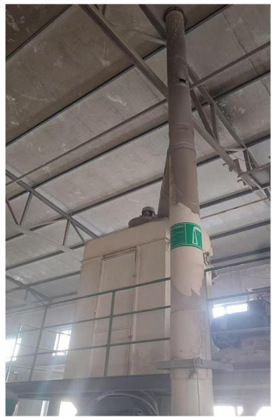
磨粉工艺排气筒 P4
