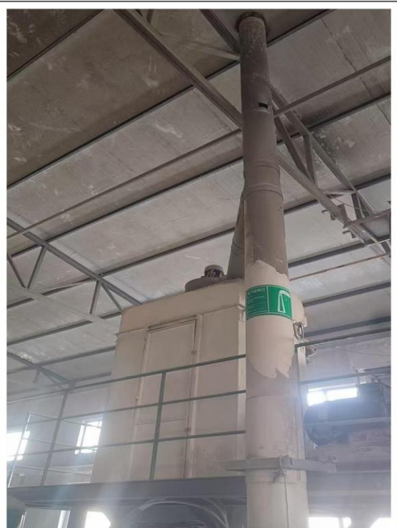
磨粉工艺排气筒 P4
