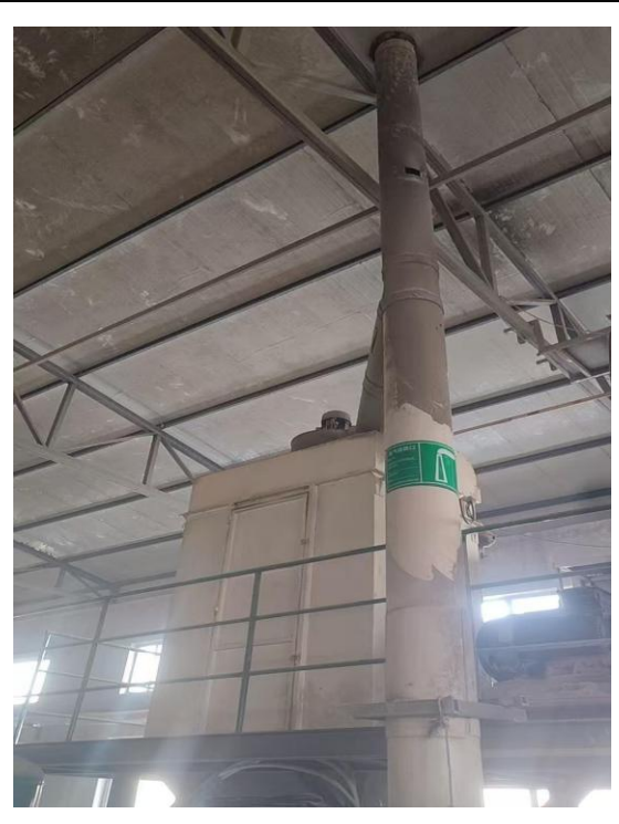
磨粉工艺排气筒 P4
