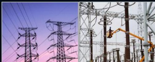
输变电网监控
